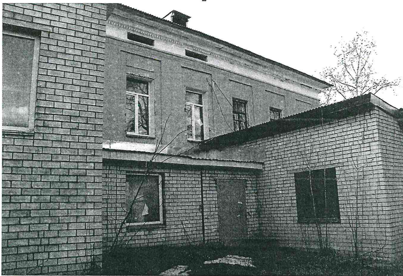
Фото № 2. Общий вид объекта культурного наследия с востока. Повреждение системы водоотведения с кровли; повреждение отделочных покрытий фасадов; замокание кирпичной кладки цоколя; повреждение оконных заполнений; повреждения отмостки; поздние каменные пристрой. Фото 18.04.2023.
